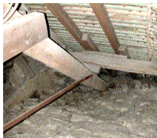
Fig. 12 Arbalétrier de la chapelle nord, vrillé, déchaussé de sa sablière en pied, et qui s'appuie directement sur la voûte.
