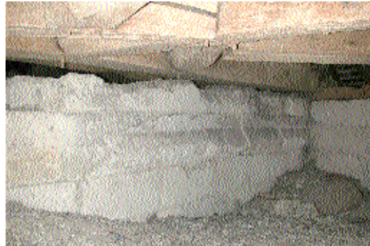
Fig. 10 Restes de l'ancien mur pignon arasé au XVI e siècle avec son larmier extérieur, vue sous la croupe actuelle.
