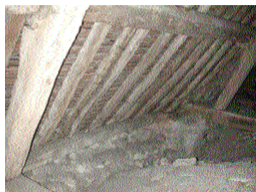
Fig. 8 Déformation des sablières suivant la poussée des voûtes sur les murs gouttereaux.
