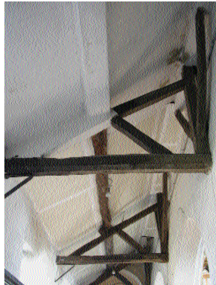
Fig. 3 Demi-fermes de la charpente en appentis du bas-côté nord de la nef.
