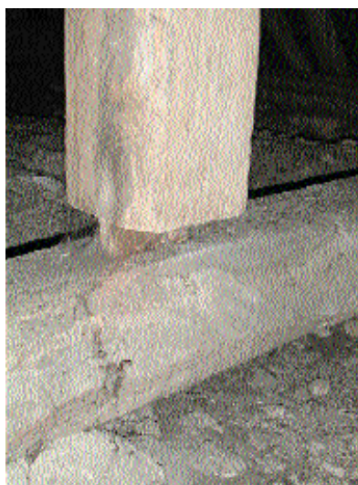
Fig. 10 Absence de cheville au pied de poinçon. L'entrait est sorti de son assemblage.
