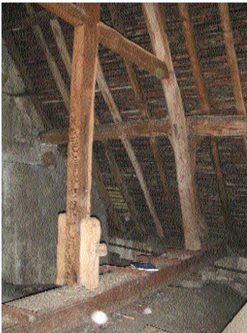
Fig. 7 Croisillon nord. Bois débité du poinçon et moises pendantes coupées par un IPN
