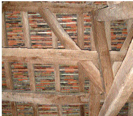
Fig. 10 Ouverture dans les assemblages, provoquée par l'abaissement de la ferme.
