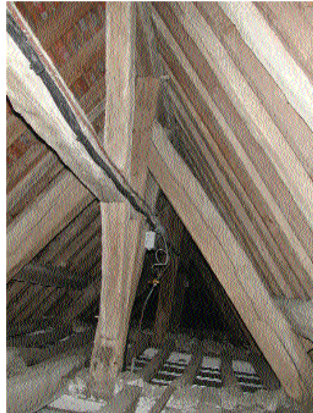
Fig. 2 Partie haute des fermes de la nef avec vue de la sous- faîtière.
