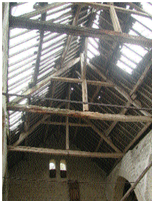
Fig. 4 Fermes à poinçon de fond sur la partie nord de la grange
