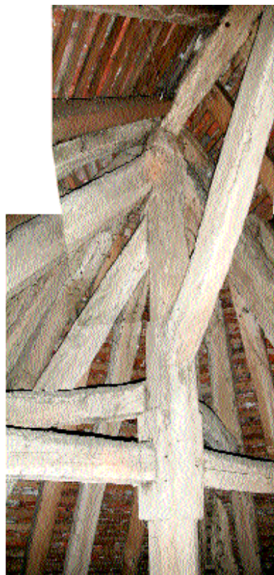
Fig. 17 Partie haute du poinçon de la ferme de croupe avec ses surépaississements pour les assemblages des faux entrains et des arbalétriers en tête.
