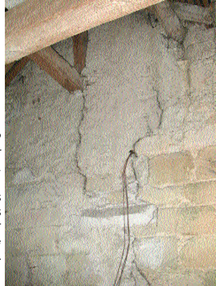
Fig. 9 Fissures dans le mur de la tour clocher, provoquées par la pression des pannes ancrées dans les maçonneries, du fait de l'affaissement de la charpente.
