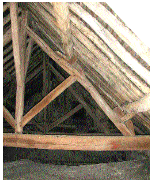
Fig. 12 Fixation des pannes sur l'arbalétrier. Noter la déformation du bois sous le poids des pannes
