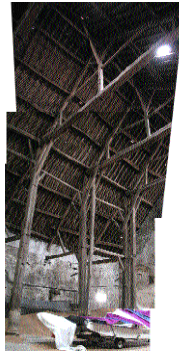
Fig. 5 Poteaux du XIIIe siècle, doublés par des étais.
