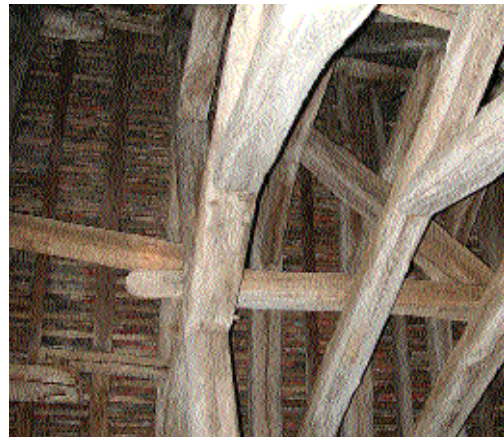
Fig. 3 Tenon de la sous-faîtière traversant le poinçon de la ferme principale. La clavette de maintien, fixant le tenon au dos du poinçon, a disparue.
