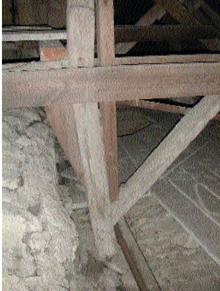
Fig. 8 Rupture du poteau réemployé, déchaussé en pied de son assemblage dans la sablière, aujourd'hui très détériorée.
