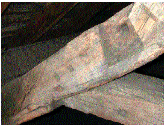
Fig. 9 Entaille à mi-bois avec sa marque d'assemblage (à gauche sur la photo) sous la forme de trois encoches carrées faites au ciseau
