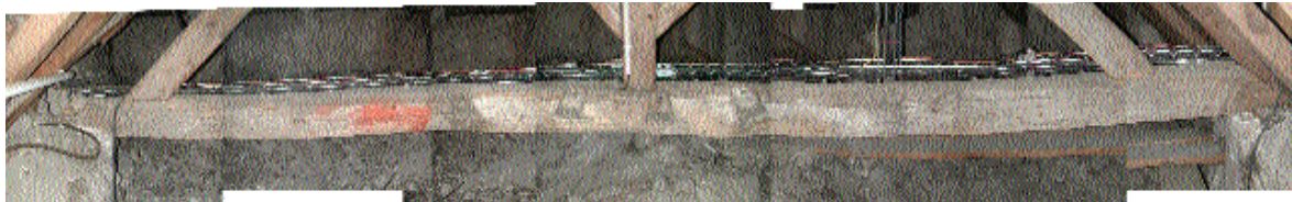
Fig. 12 Réemploi en entrait d'un entrait roman. On distingue les entailles des assemblages à mi-bois à queue d'aronde pour les éléments de raidissement de la ferme primitive.
